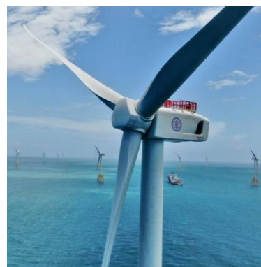
離岸風力發電機
